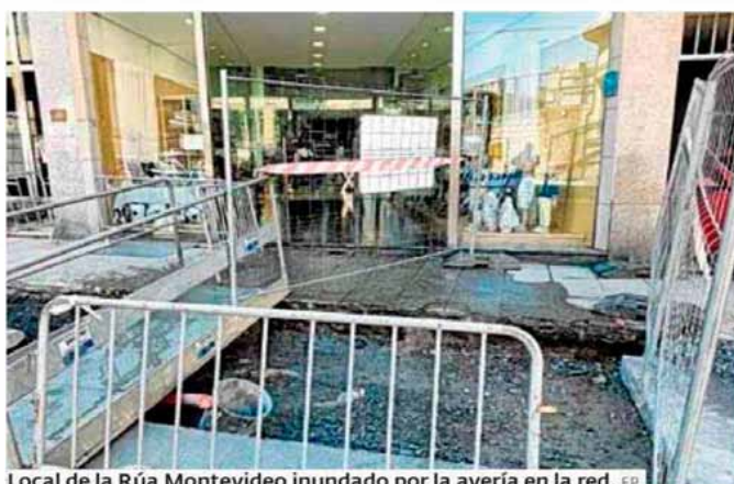
Local de la Rúa Montevideo inundado por la avería en la red. EP
